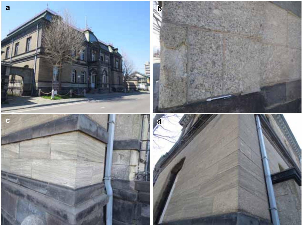
第12図 小樽軟石の活用例としての旧日本郵船株式会社小樽支店（国指定重要文化財）と石材としての小樽軟石の産状. a: 小樽軟石の活用例:旧日本郵船株式会社小樽支店（国指定重要文化財）. 1904（明治37）年に着工し1906（明治39）年に竣工した、明治時代の洋風石造建築を代表する建造物の1つで工部大学校（現東京大学工学部）第1期生の佐立七次郎が設計した. b: 石材としての小樽軟石（軽石凝灰岩）の産状. 石材業者はこのような小樽軟石を「玉目」と称している. c: 石材としての小樽軟石（ラミナの発達した砂質凝灰岩）の産状. 石材業者はこのような小樽軟石を「縞目」と称している. d: 石材としての小樽軟石の産状（玉目と縞目の石材が程よく組み合わされて美観を呈している）.
