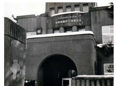
支所玄関の様子(表面のコンクリートが剥がれた門柱修理要求用の写真)。
